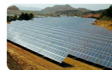
원광썬텍 태양광발전소[1MW] (당사보유 및 유지관리)
