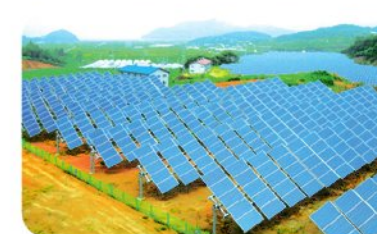
신광썬텍 태양광발전소 [200KW] (당사보유 및 유지관리)
